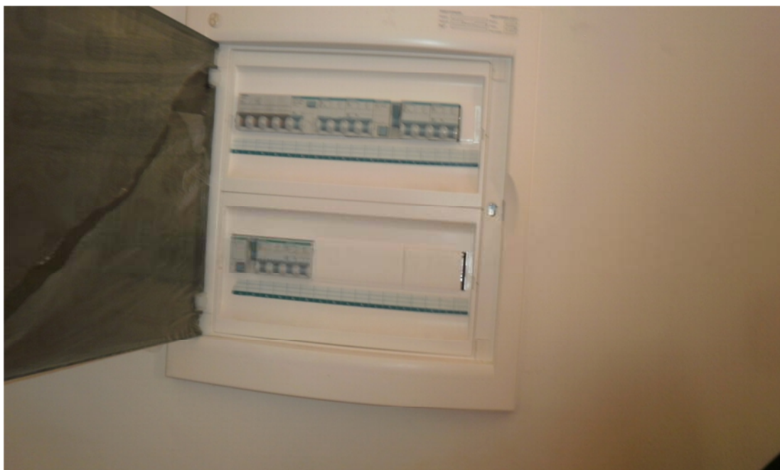
Foto n°3 : Particolare quadro elettrico esistente
