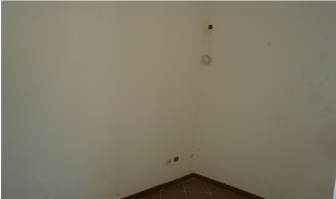
Foto n°4 : Particolare impianto elettrico esistente
